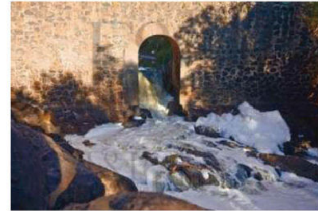
Imagen 5.35. Agua contaminada en el acueducto del Padre Tembleque en Tepeyahualco, Hidalgo.
